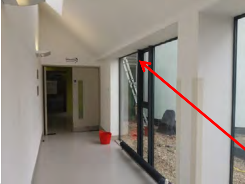
28. Leak Site Below
